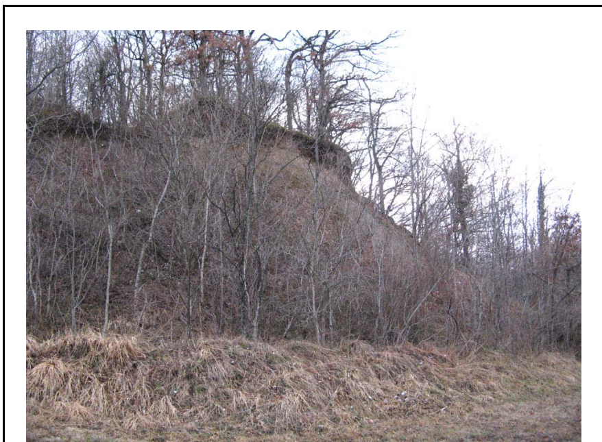
Eloise-EG1 : Au dessus de la RN508 aux Vernettes – Rupture brutale du versant et glissements de talus.
