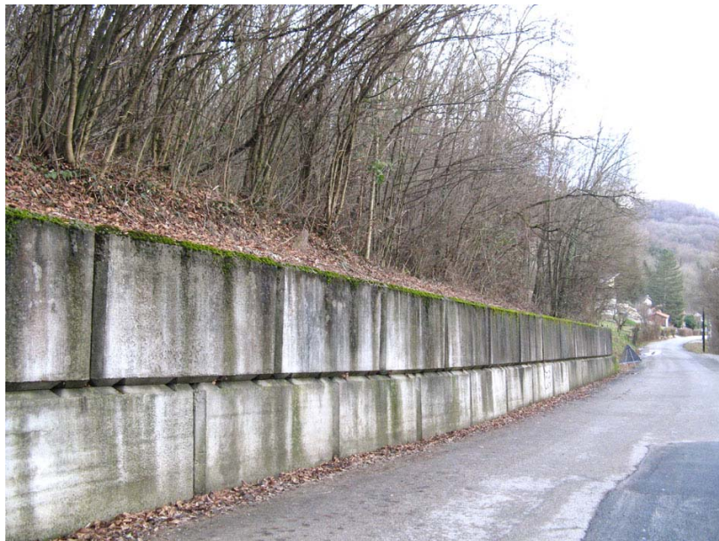
Eloise-OG1 : Route d'Essertoux – Soutènement de talus par des blocs béton sur un versant localement déstabilisé.
