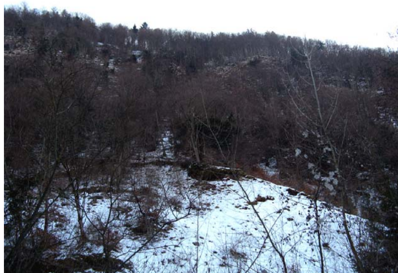
Vougy-EGP1 : Entre le rocher de la Praz et le Rocher Noir – Loupes de glissements peu profonds en pied de talus.
