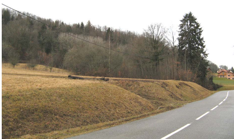
Charvonnex-EG2 : Talus d'une route communale aux abords du ruisseau de Talloires – Loupes de glissements localisées.
