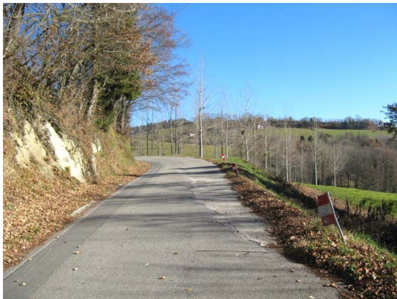
Clermont-EG1 : RD31, en sortant du thalweg du ruisseau d'Essert – Affaissements localisés de la chaussée.
