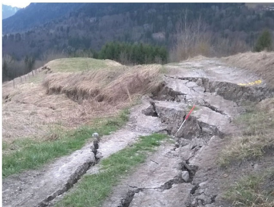
Glissement de terrain à Reyvroz - Haute-Savoie - 2017
