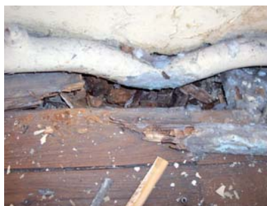
fuite de canalisation
