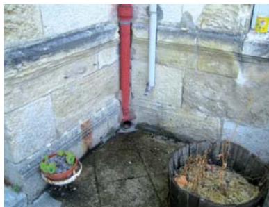
robinet et gouttière à réparer
