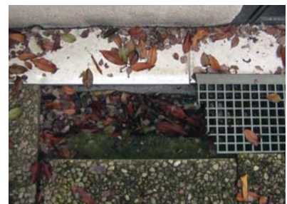
égout à nettoyer
