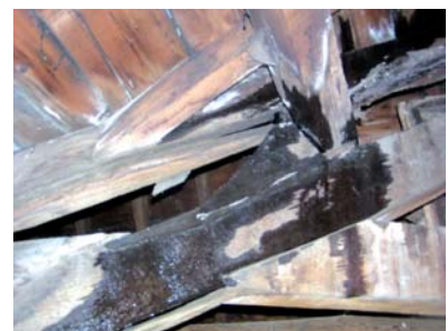
infiltration en toiture
