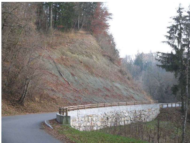
Chilly-EG3 : RD197, au Bois Bugnin – Glissements de talus et mise à nu de la roche mère.
