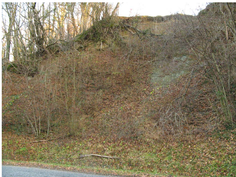
Chilly-EG1 : RD197, aux Roulys – Déstabilisation du talus avec extension des glissements vers le haut.
