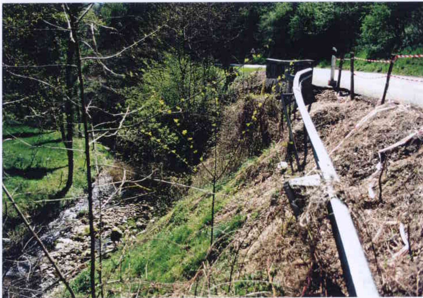
Torrent de la Néphaz et instabilités dans les berges ayant entraînées une glissière de sécurité.
