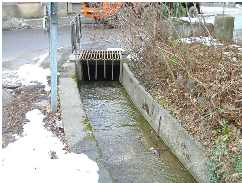
Loisin-OT2 : RD1206 à Tholomaz – Protection de la section souterraine du ruisseau par une grille.
