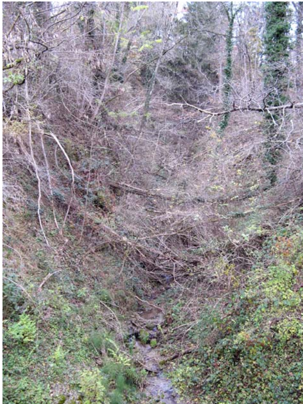
StEusebe-EG2 : Ravin de la Chaudière, en amont de la RD38 – Encombrement du lit par la végétation.
