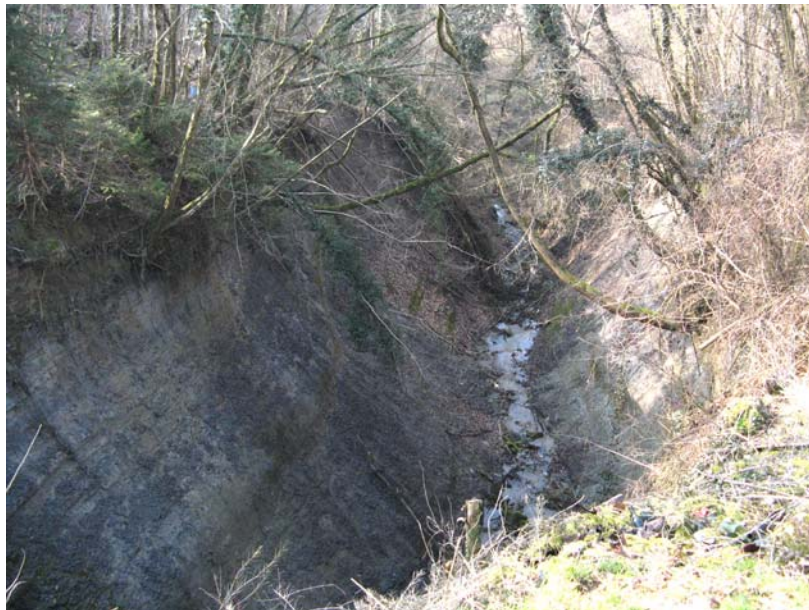
StEusebe-EG1 : Ravin de la Chaudière, en aval de la RD38 – Profond encaissement du lit dans des terrains molassiques.
