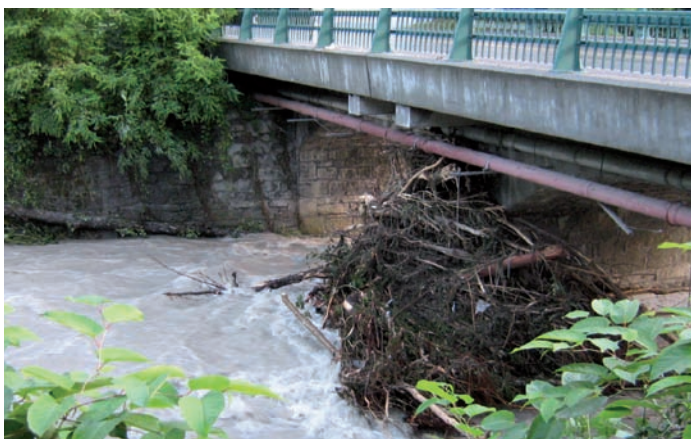
Crue de la Ménoge à Fillinges. Juillet 2007 Source : RTM 74
