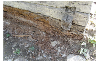
Absence de soubassement
