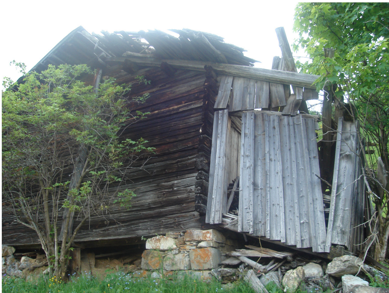
Dégradation de la toiture
